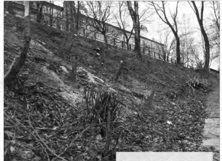
Skarpa po częściowej wycince i uprzętnieniu nie stwarza już niebezpieczeństwa dla przechodzących nią ludzi.
