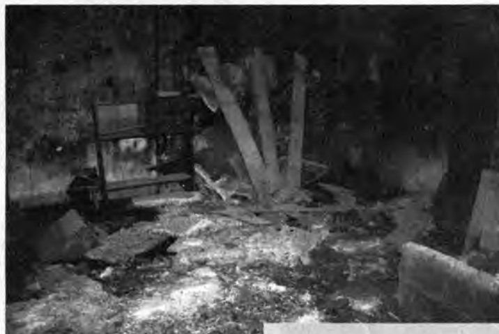
Wypalone wnętrze mieszkania przy ul. Sobieskiego.
