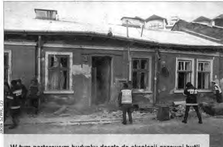
W tym parterowym budynku doszło do eksplozji gazowej butli.
