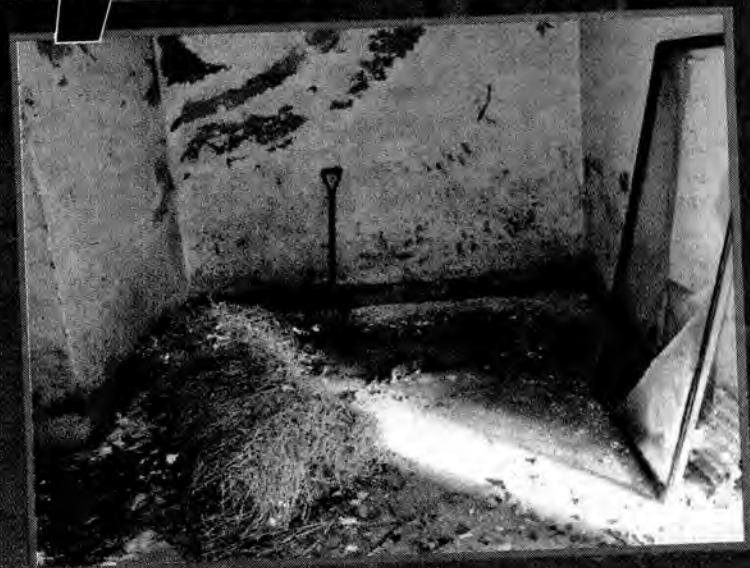
Dawny szpital przy Wysockiego zarasta trawą. Popękaly już rury, przemarły tynki, wypaczyła się stolarka.
