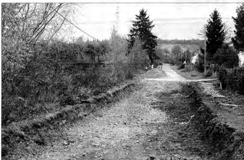
Czynne osuwisko na Zielonce wymaga palowania sporego fragmentu ul. Pasteura.
