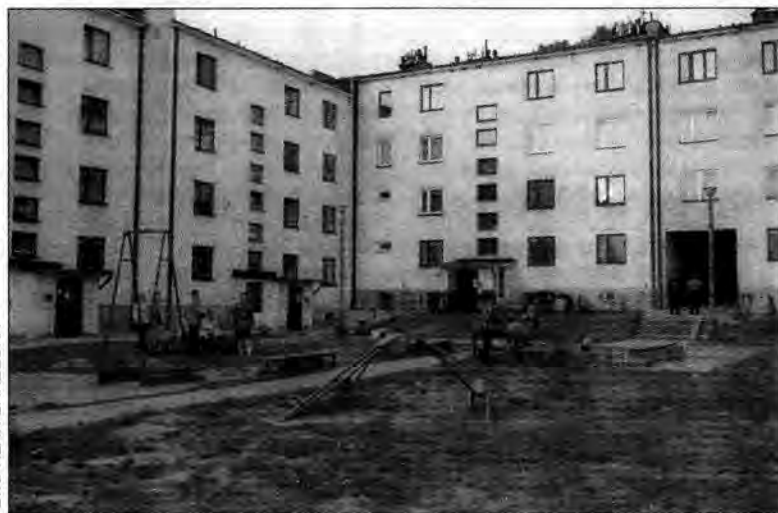
Niestabilny grunt i brak kanalizacji deszczowej powodują, że bloki zaczynają pękać.
