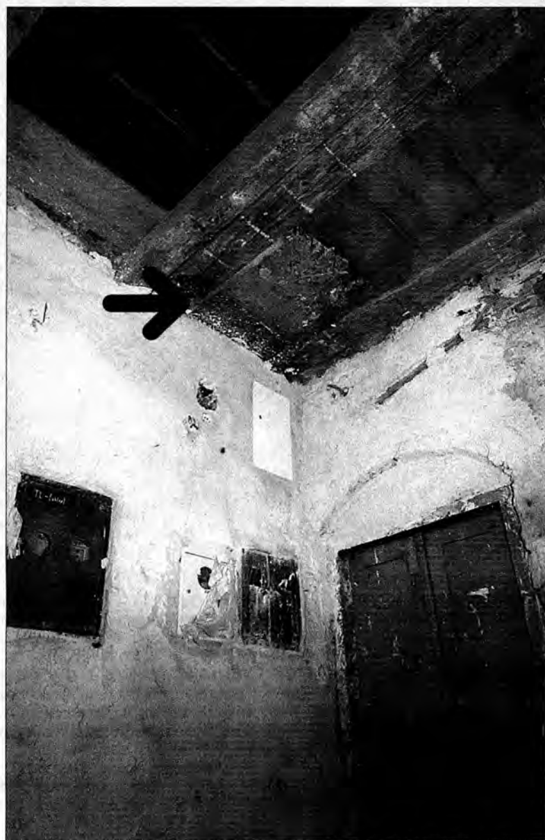
Strop w bramie kamienicy przy ul. Słowackiego 1 gdzie znaleziono orzełki.
