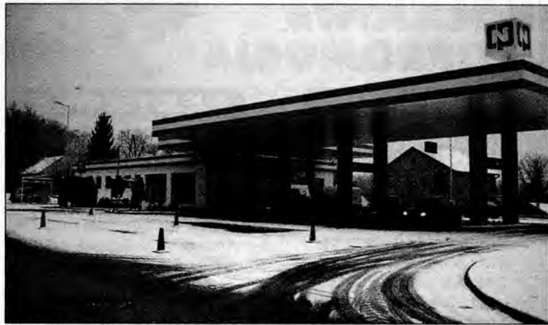
W najbliższych dniach zostaną zakończone prace modernizacyjne na stacji CPN w Przemyślu.
