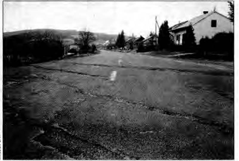
Dziury, koleiny i przelomy to najczęstsze uszkodzenia naszych dróg.
