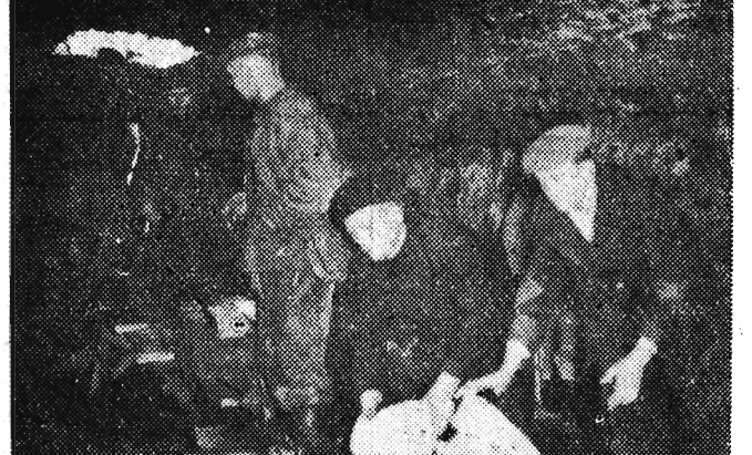
Nasz fotoreporter zapuścił się tym razem aż pod ziemię... do kanału rzeki Mikołki, gdzie prowadzone są ostatnio prace zabezpieczeniowe.
