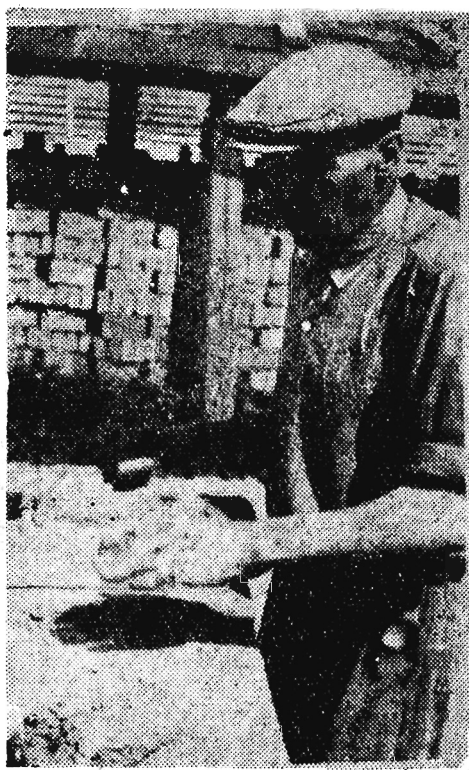
Na razie cegłę urabia się ręcznie, powoli, ale później maszyną przyspieszy pracę, bo cegiel na budowę szpitala i liceum trzeba bardzo dużo. Foto — (s)
