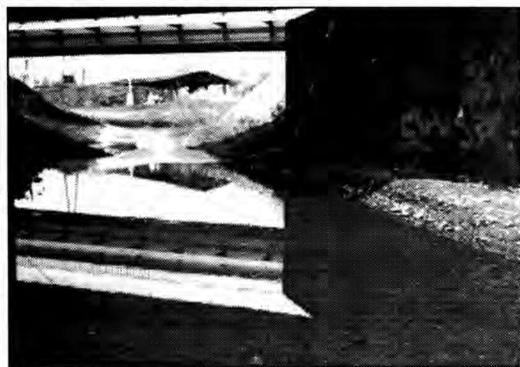
— „Jezioro” pod wiaduktem przy ul. Ceramicznej za chwilę zmieni się w rzekę.
