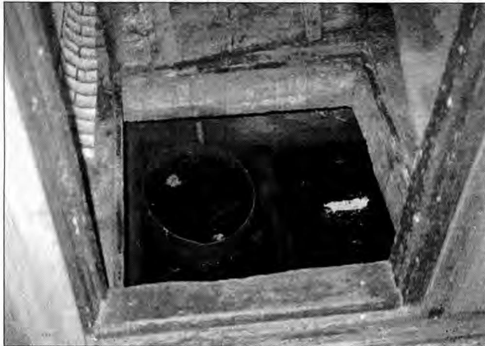
– Gdy spadnie tylko trochę deszczu w piwnicy powstaje jezioro.
