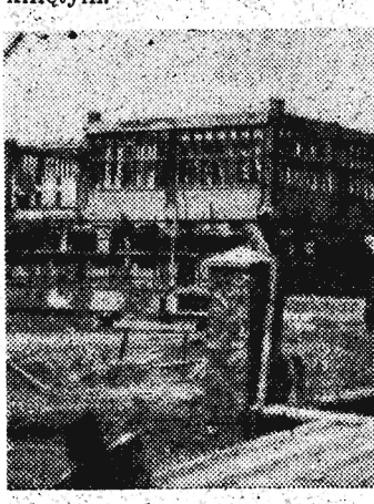
Fragment głównej hali produkcyjnej Huty Szkła Technicznego w Polance, gdzie wykonano już pewne prace montażowe.
