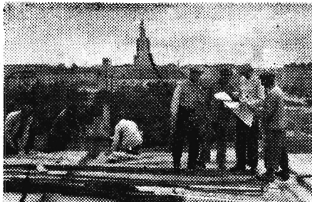
Na zdjęciu: Brygada cieślińska Wacława Pniewskiego (ZBM Nr 2 w Warszawie) pracująca przy budowie bloku mieszkalnego Nr 320 przy ul. Nowotki (Nowy Muranów) zobowiązała się wykonać szalunek IV b. segmentów A i B oraz rozszalować i piętrowo te bloki do 15. X. 1955 r. Brygada Pniewskiego osiąga średnio 240 proc. normy. CAF — fot. Tyński.
