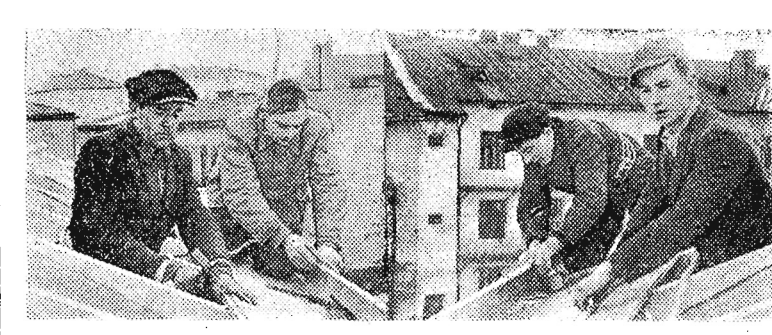
Po wyczynie ciesielskim, robotnicy budowlani zatrudnieni przy budowie gmachu mieszkalnego ZOR przy ul. Helmaniskiej podjęli wyczyn blacharski.
