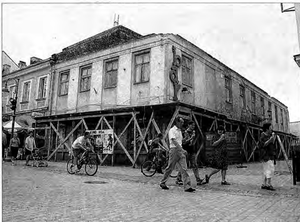
Ściana kamienicy w każdej chwili może runąć na ul. 3 Maja.
