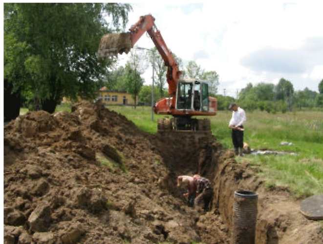
Kanalizacja Tyczyn, Osiedle 600-lecia
