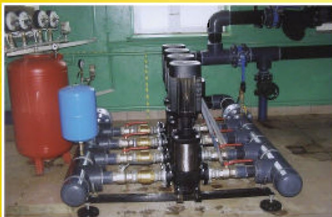
Stacja uzdatniania wody w Budziwoju została wyposażona m.in. w nowe pompy
