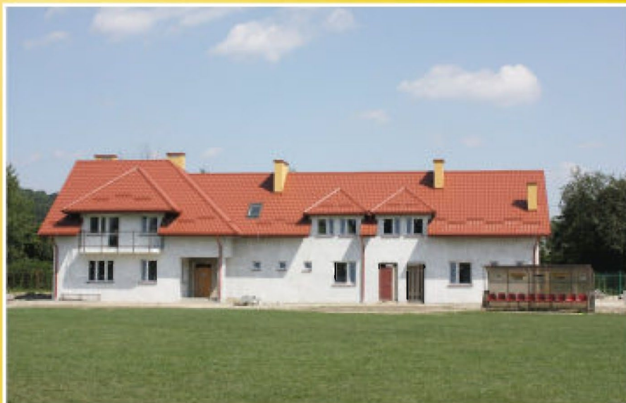
Stadion Tyczyn. Modernizacja budynku pawilonu zaplecza znajduje się w końcowym etapie realizacji
