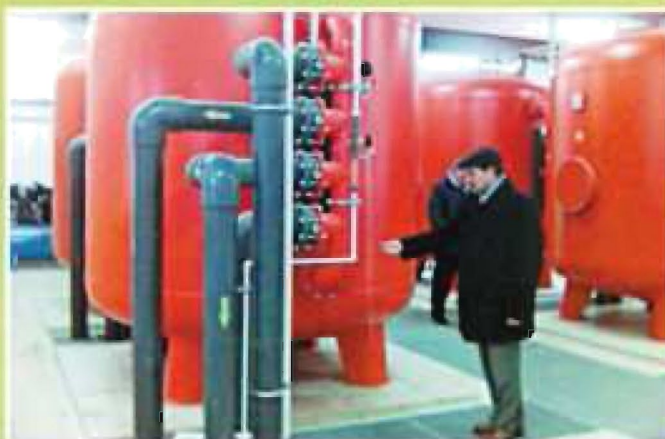
Urządzenia technologiczne wewnątrz Stacji, filtry ciśnieniowe
