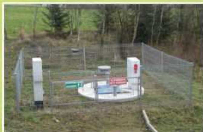
Nowa przepompownia ścieków w Kielnarowej
