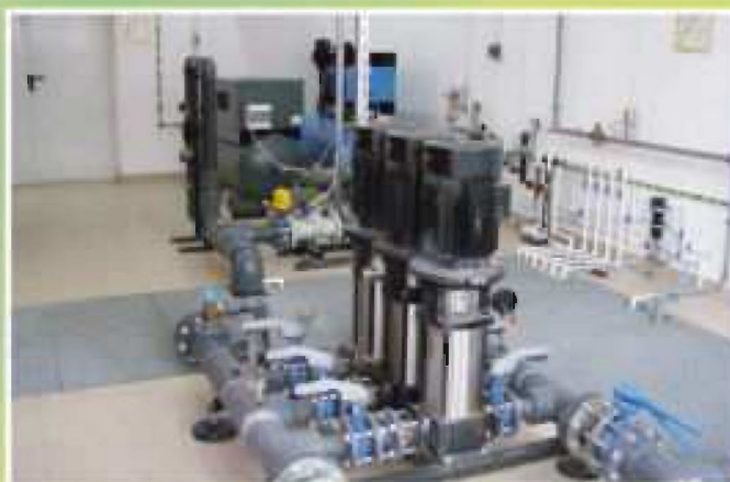
Urządzenia technologiczne wewnątrz Stacji, zestaw pomp II stopnia
