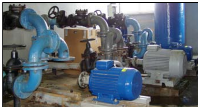
Urządzenia w budynku ujęcia wody w Wesolej Ujazdach
