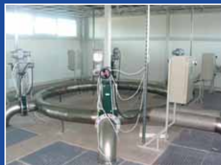
Instalacja technologiczna odstożników
