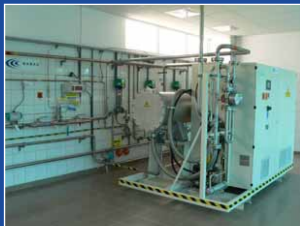
Instalacja generatorów ozonu w NBT
