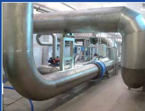
Rurociągi technologiczne w NBT
