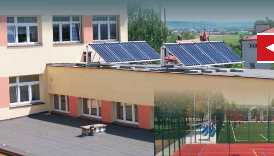
◀ Kolektory na budynku Szkoły Podstawowej w Boguchwale
