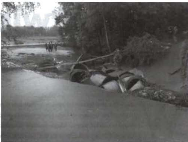
Fot: Zerwany most w miejscowości Wydrze.
