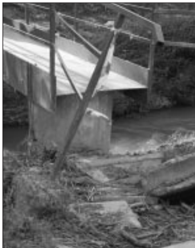
Zniszczone dojście do kładki na stadion Lechii w Śędziszowie Młp.
