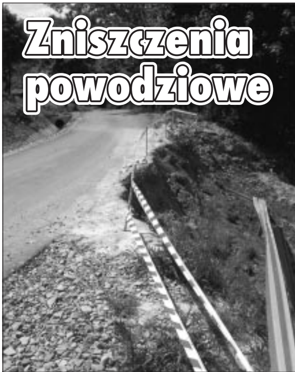
Szkodna-Budy – osuwisko przy drodze gminnej.
