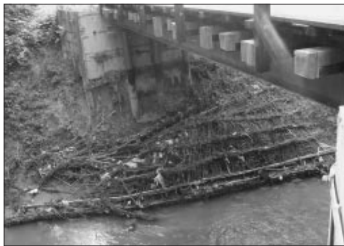
Góra Ropczycka – Budy, powódź zniszczyła umocnienie przyczółków mostu.
